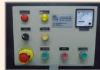
Painel de comando
