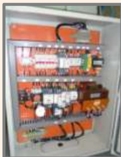
Painel Elétrico NR10
